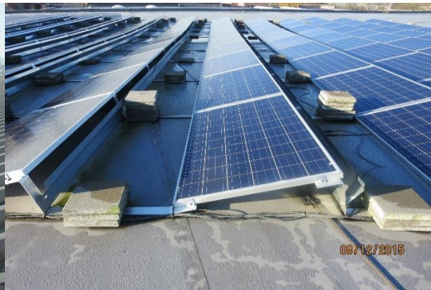
Kabels onder de daklast en water in het midden van het dak Bron: Burghgraef Van Tiel & Partners
