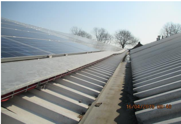
Doorzakken van het dak Bron : Univé
