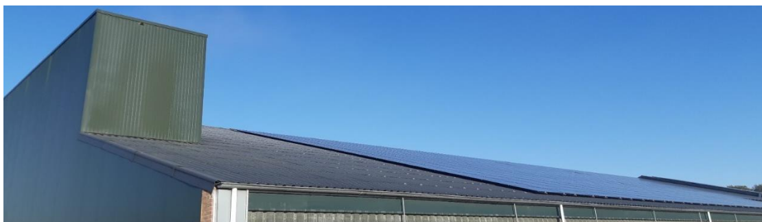
Goede afstand tussen luchtwasser en PV
