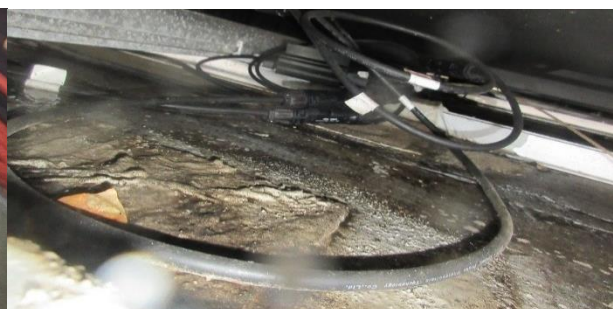
Connectoren liggen op het dak en de panelen te dicht op het dak Bron: Burghgraef Van Tiel & Partners
