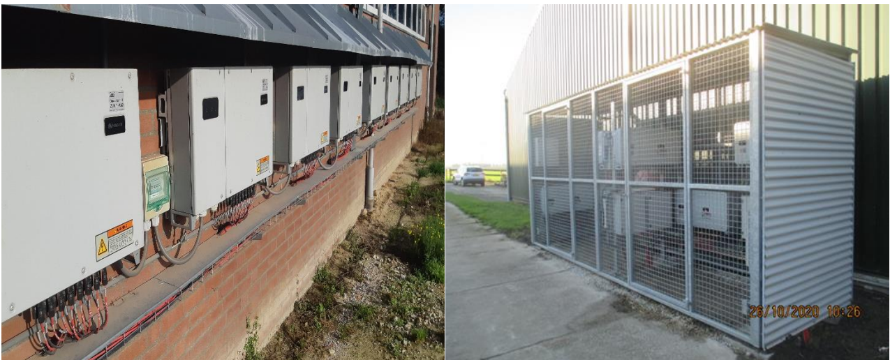
Buiten geplaatste omvormers Bron : Achmea/SOBH
