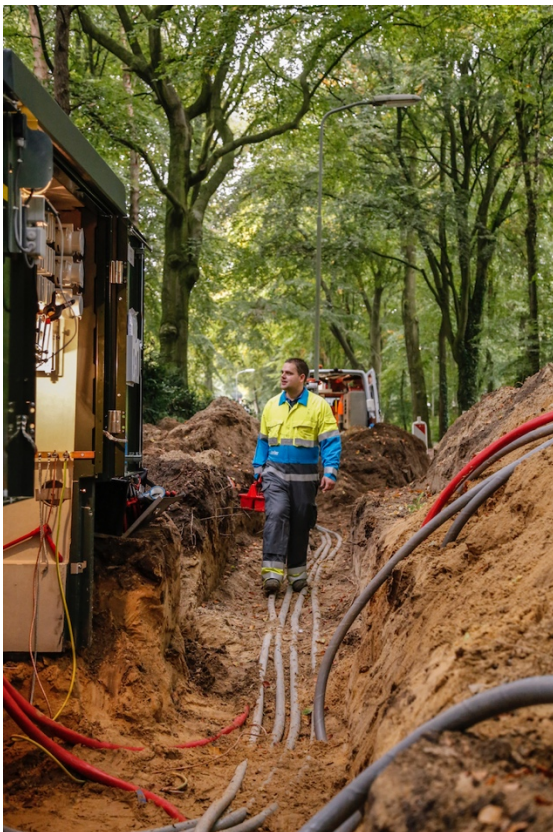
Verzwaring van het laagspanningsnet – bron: Alliander - fotograaf Jack Tillmanns
